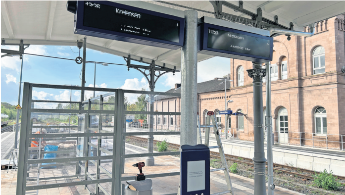
Neue Zuglaufanzeiger (oben) auf dem Mittelbahnsteig und ein digitaler Infopunkt (unten) zur Kontaktaufnahme mit der Bahn.
